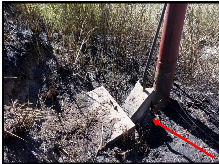
Fotografía No. 16 Bases de los postes del sistema de aproximación.
