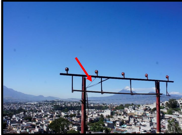
Fotografía No. 15 Daños en el sistema de corriente eléctrica.
