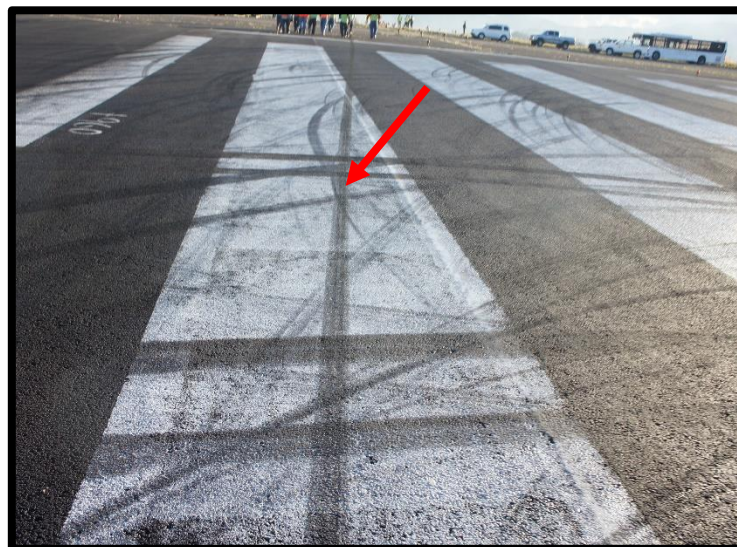
Fotografía No. 22 Líneas del frenado marcado al final de la cabecera de pista.
