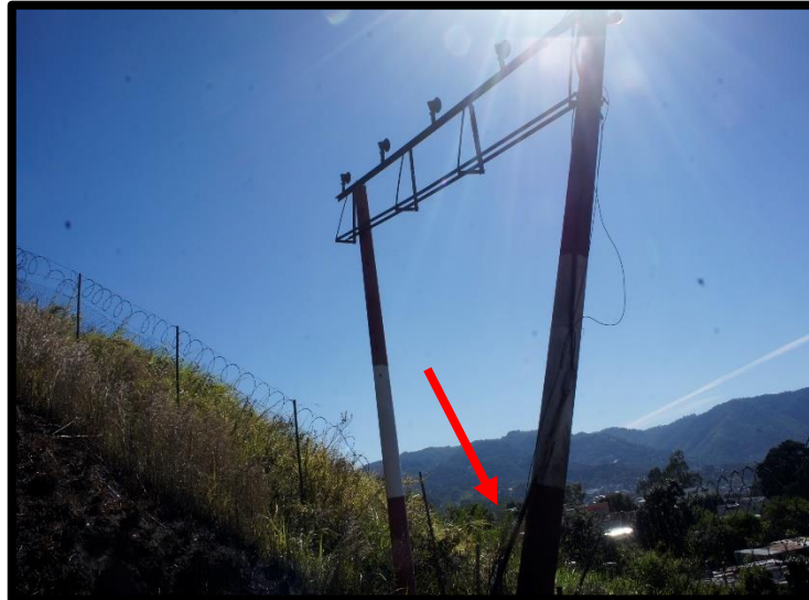
Fotografía No. 17 Sistema de luces de aproximación a pista desalineado.
