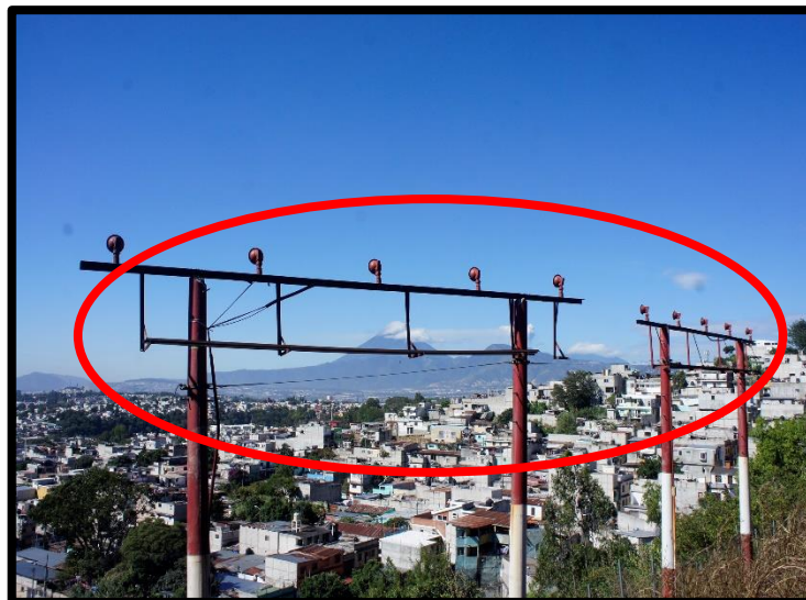
Fotografía No. 14 Sistema de luces de aproximación desalineadas en la cabecera de pista.
