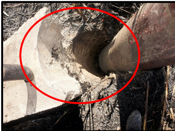
Fotografía No. 20 Vista de la separación de los postes de su base.
